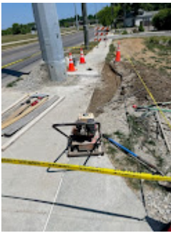
M200240 814-6504 sidewalk repair.jpg
