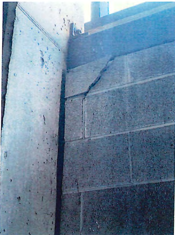
11 - CMU wall crack.JPG
