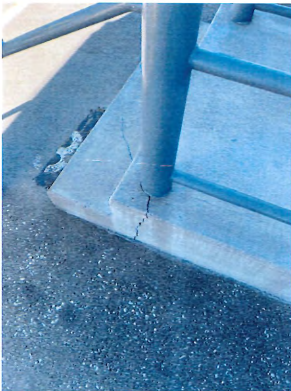
15 - spalled concrete step.JPG
