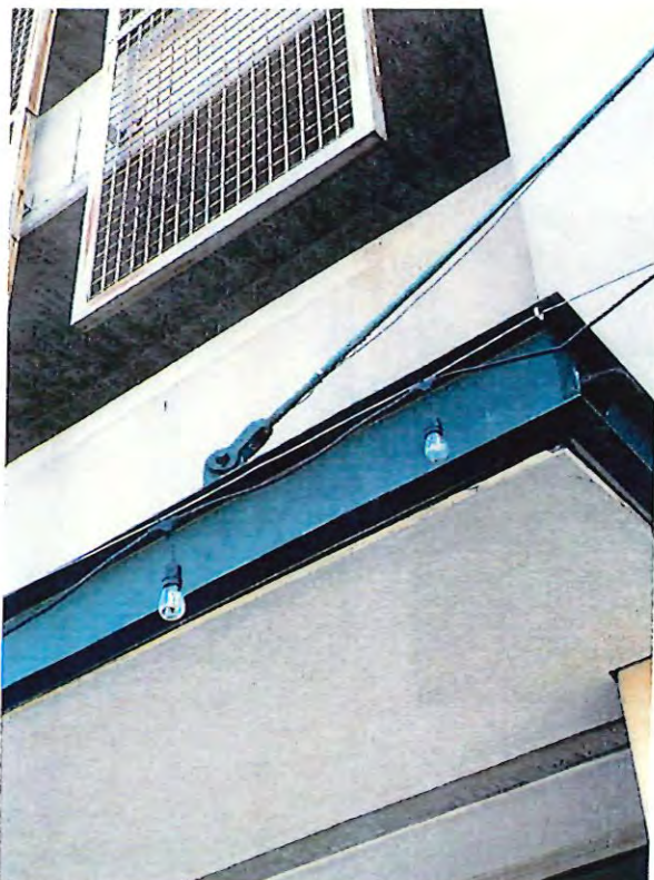
35 - awning hangar corrosion.JPG
