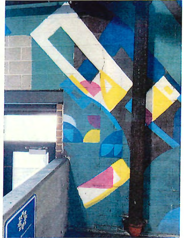
10 - CMU wall crack.JPG
