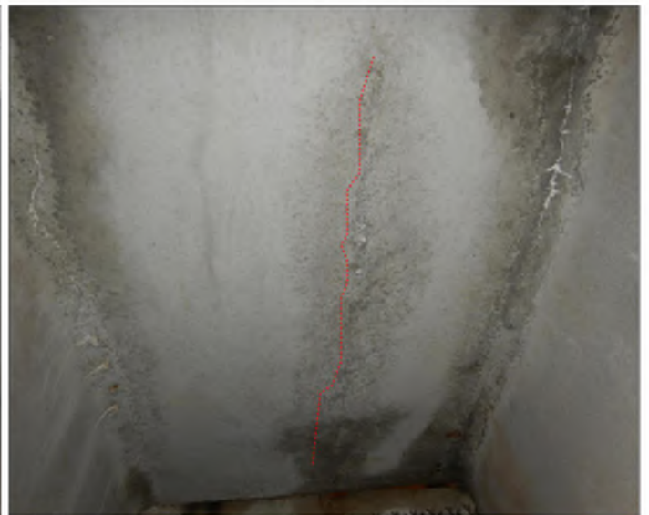
REPAIR ID - 07B-1
